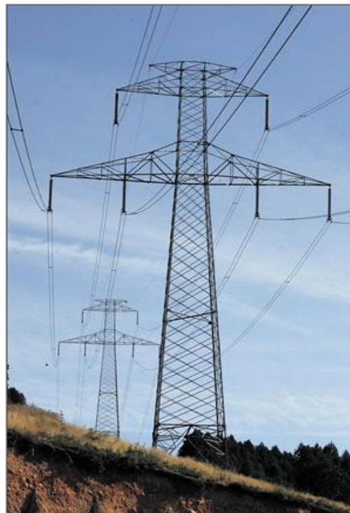
Transporte de enerxía eléctrica
